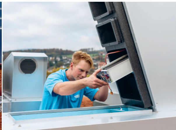
Maintenance aisée sur le toit
