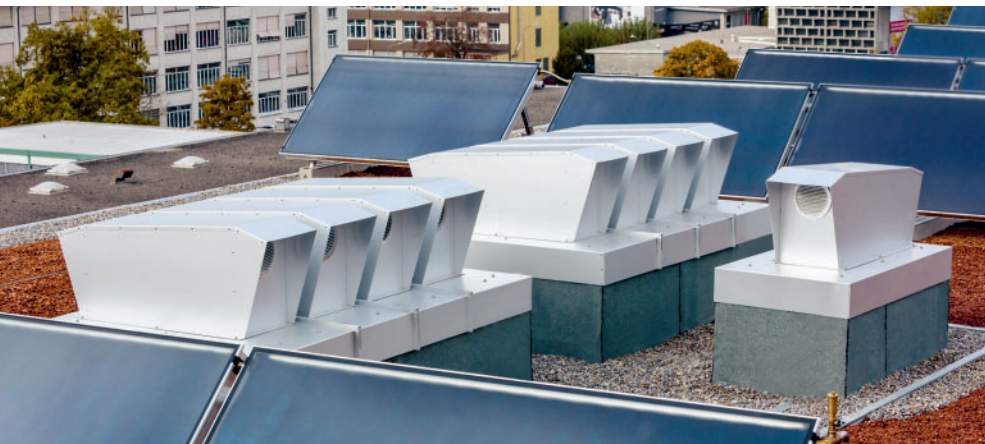
Encombrement minimal grâce à l'installation des appareils sur le toit
